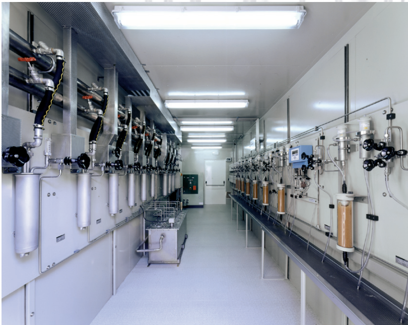
Klimatisierter 25-Fuß-Container Air conditioned 25 feet container
